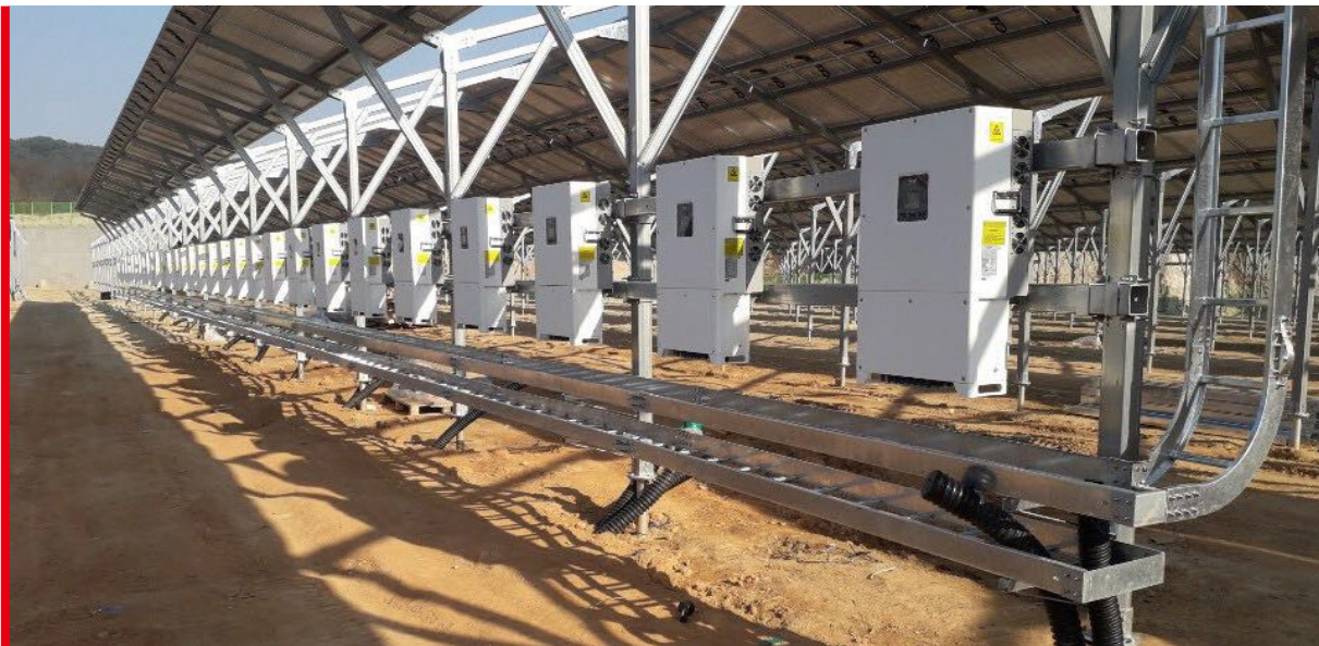
Elektrownia fotowoltaiczna w Korei
