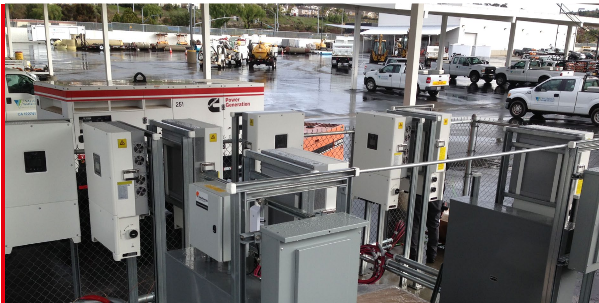
Elektrownia fotowoltaiczna generująca energię rozproszoną dla parkingu w San Marcos w Stanach Zjednoczonych
